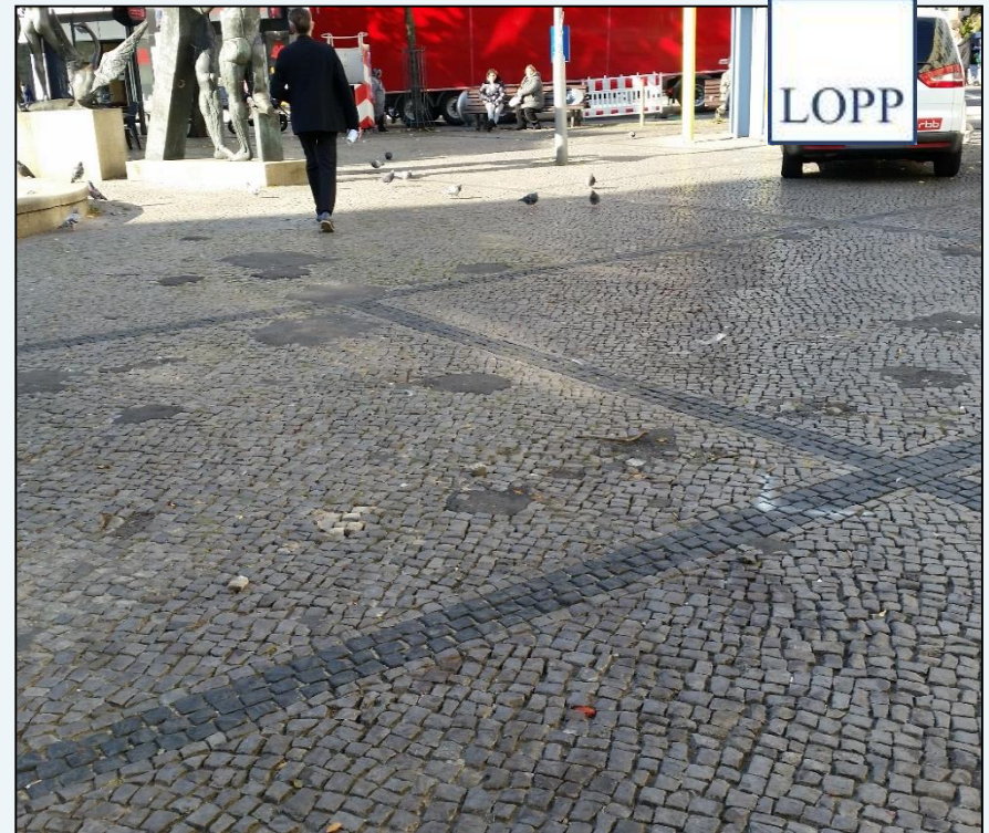
fehlende Steine / Löcher
