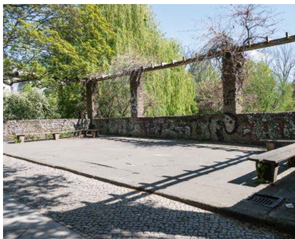
Eine mögliche Sanierung der Pergola wird zurzeit geprüft
