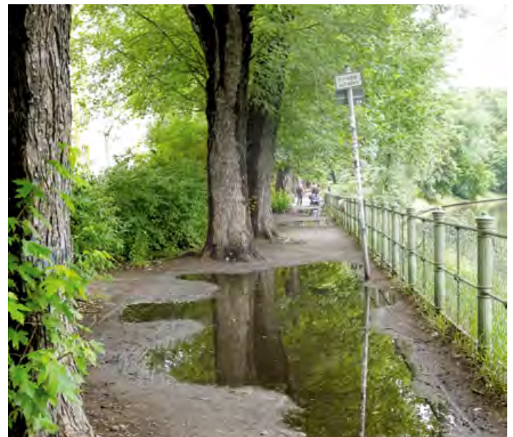
Schlechter Zustand des Uferwanderwegs
